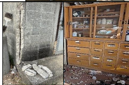
↑壁が落ちたテニス部室と 試験管などが落ちた理科準備室
